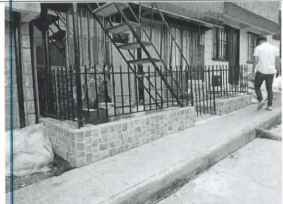
Foto No. 6 Cerramiento, endurecimiento e intervención sobre zona verde con construcción de tarima
