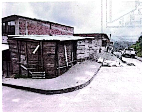
Foto No 1. Fachada del inmueble ubicado en la CARRERA 10A No. 59-06, material de obra sobre la vía vehicular y el andén peatonal.
