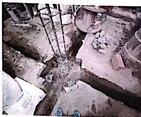
Foto No 5. Excavación y fundida de las zapatas de cimentación, sobre sale el acero de refuerzo para continuar con las columnas
