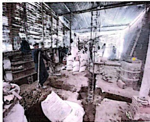
Foto No 2. Excavación para la adecuación de las vigas de cimentación, acero de refuerzo para las columnas.
