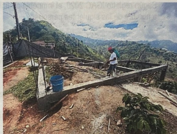
Foto No. 2 El personal que se encontraba trabajando, no tenía los elementos de protección y bioseguridad.
