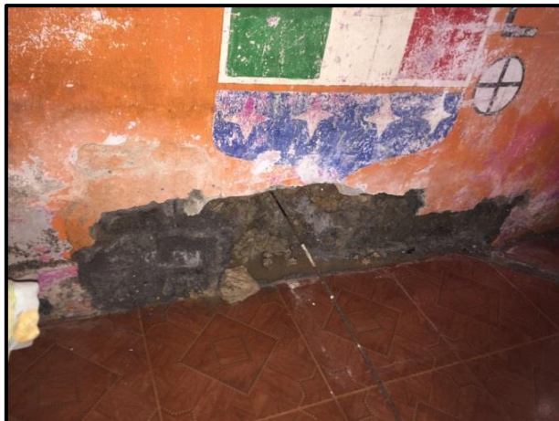
Imagen 1. Interior del orificio - Filtración.
