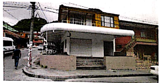
Foto No 2. Fachada principal de la vivienda por la carrera 42, en donde se visualiza la cubierta invadiendo el antejardín.
