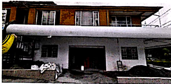
Foto No. 1 Fachada principal de la vivienda por la calle 71A, en donde se visualiza la escala en caracol y la cubierta invadiendo el antejardín.
